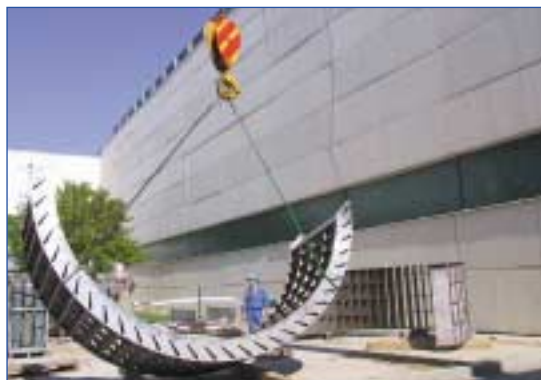
През 2002 г. бе монтиран струйно-вихров кондензатор на трети блок
